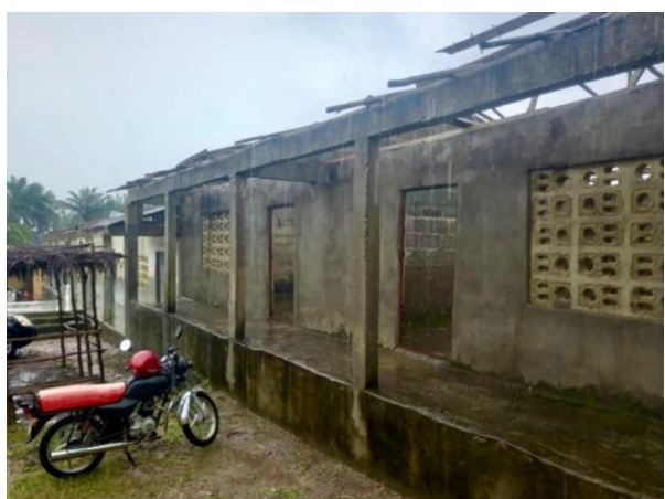
Na de storm, zwaar beschadigd
